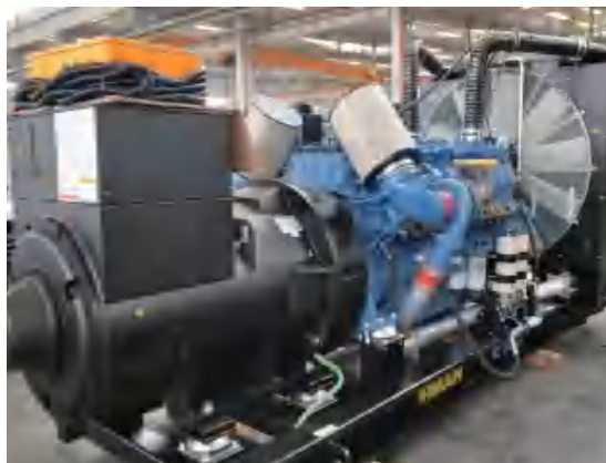
2022北京冬奥会备用电源项目
