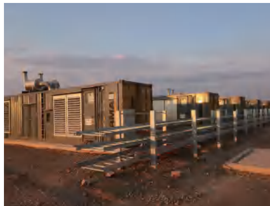
刚果金矿业备用电源项目
